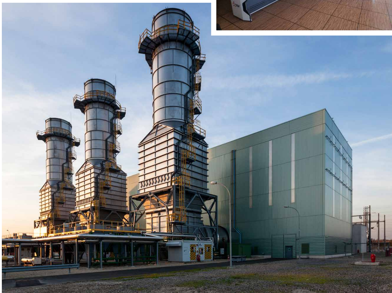
Le site de Vaires-sur-Marne : les TAC et le centre de télé-conduite (CETCO)
